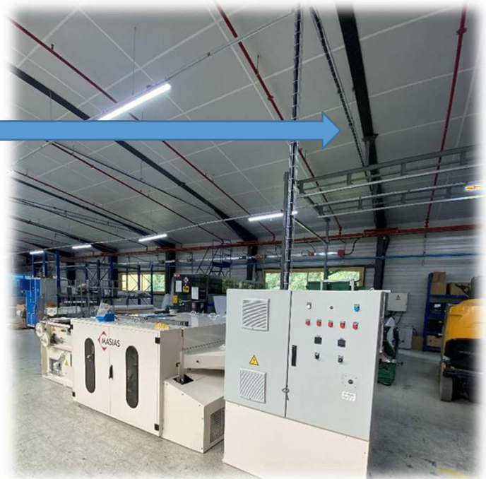
Figure 30 : chemins de câble
