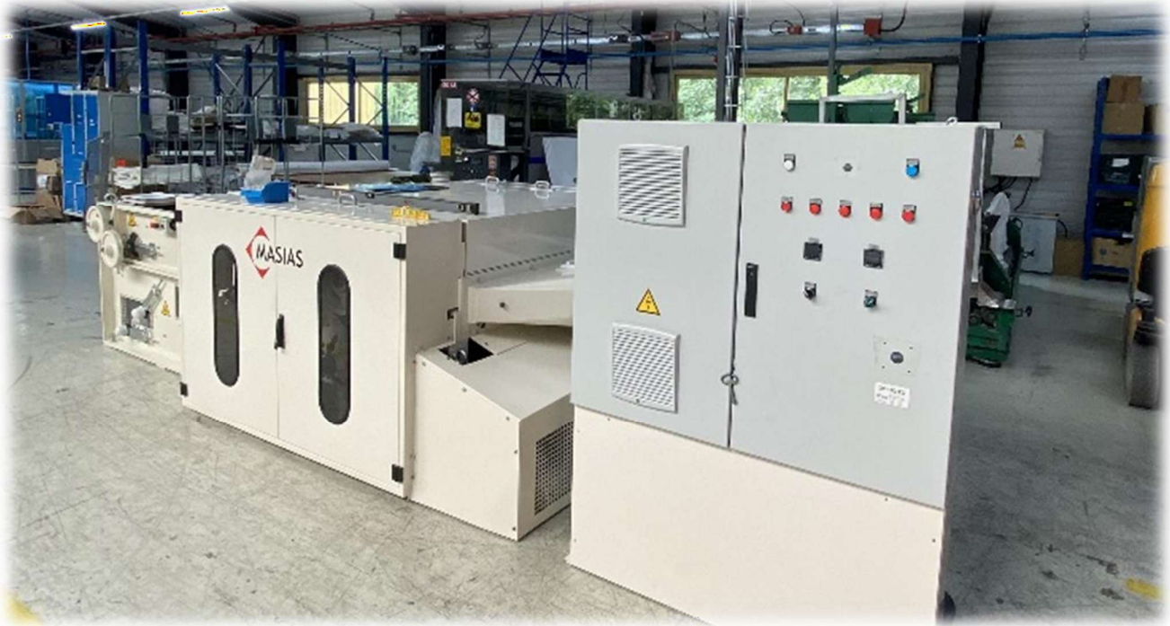
Figure 31 : machine bien installée
